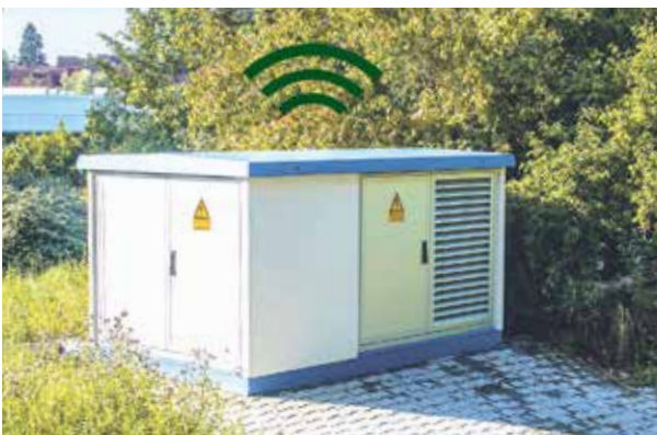
LoRaWAN-Funktechnik ermöglicht die Überwachung von Ortsnetzstationen.
