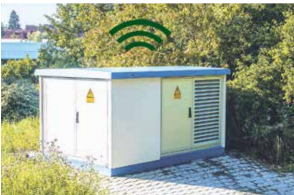
LoRaWAN-Funktechnik ermöglicht die Überwachung von Ortsnetzstationen.
